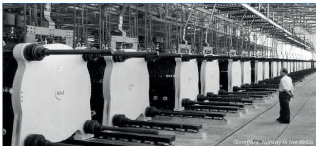
Fig. 5 - Impianto Norsk-Hydro 150 MW, 70 t/giorno, 30.000 Nm 3 /h (1948-1990)
