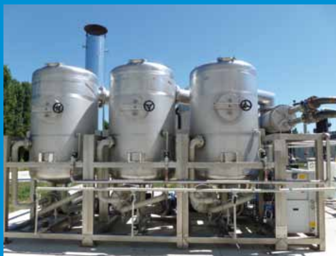
Evaporatore a triplice effetto per il trattamento del digestato
