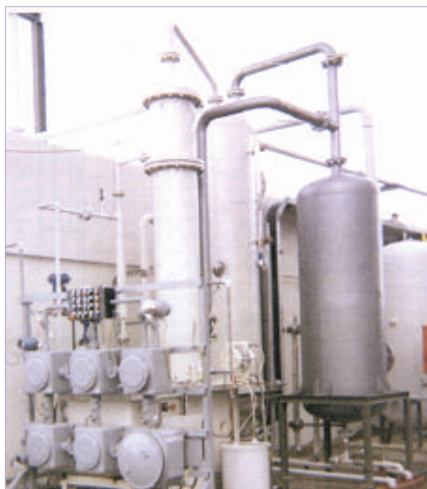
Scrubber di abbattimento dell' H_2S , con colonna di assorbimento e batteria di filtri a carbone attivo. Portata d'aria: 1.000 \text{ Nm}^3/\text{h}
