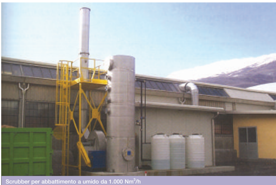
Scrubber per abbattimento a umido da 1.000 Nm 3 /h
